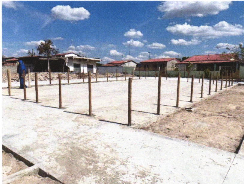
Foto 05- FORNECIMENTO E MONTAGEM DE CERCA DE PROTEÇÃO EM EUCALIPTO CLOEZIANA TRATADO A BASE DE CCA EM AUTOCLAVE, COM APLICAÇÃO DE STAIN NA COR NATURAL COM DUPLO FILTRO SOLAR, DIAMETRO DO EUCALIPTO DE 6 A 8 CM, COM ANTI-RACHA NA EXTREMIDADE. FECHAMENTO COM TELA DE ALAMBRADO FIO Nº 12 REVESTIDO DE PVC, MALHA 2.1/2 X 2.1/2", FIXADO COM FIO Nº 14 REVESTIDO EM PVC, MÓDULO MEDINDO 1,50 X 1,00M, PARAFUSOS GALVANIZADOS COM TRAVAMENTO CLICKFIX, CONFORME PROJETO
